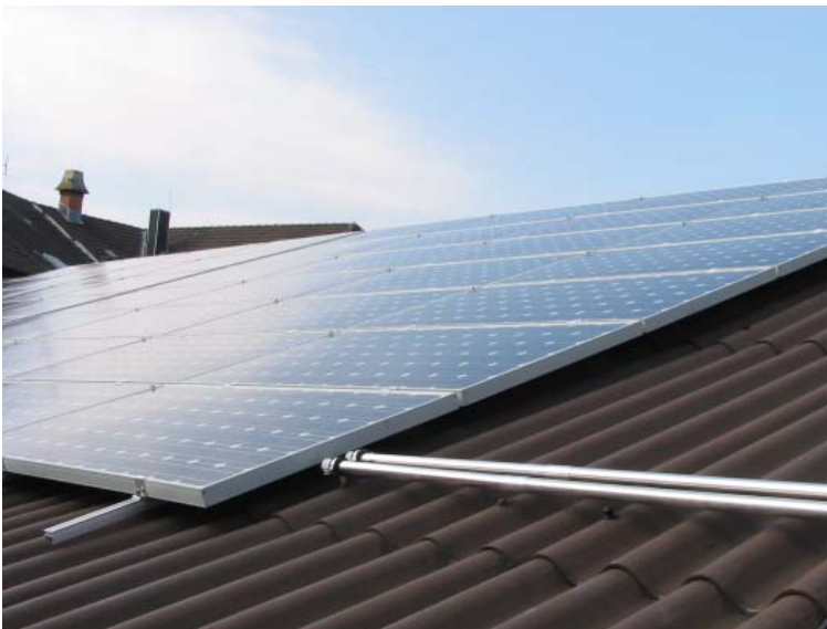
Fotovoltaik-Anlage auf dem Dach des Verwaltungsamtes
