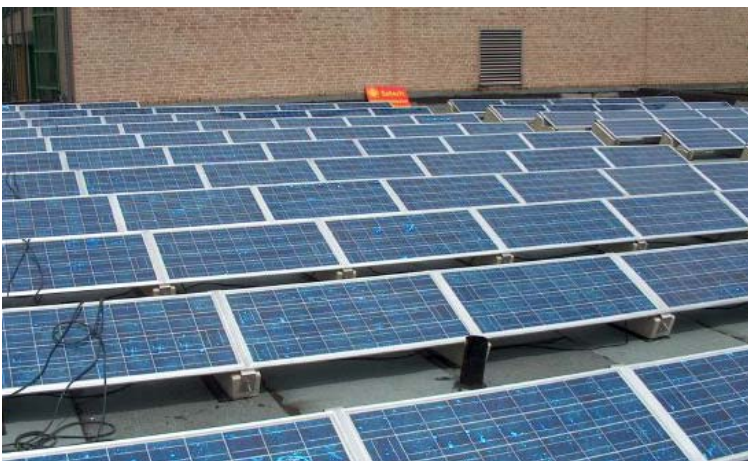
Solaranlage auf der GHS Aretzstraße
